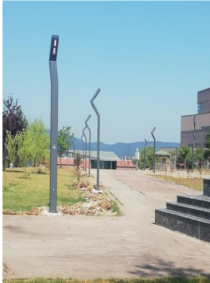
Elektrik Altyapısı Görsel
